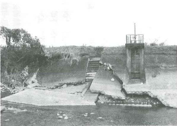
昨年9月の台風9号で損壊した下大貫頭首工
