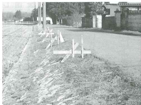
舗装部の補修が待たれる現地の様子
