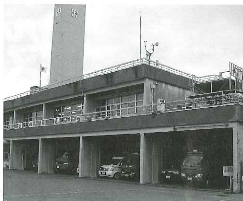
老朽化が進む黒磯那須消防組合本部
