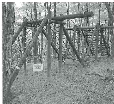
使用禁止となっている遊具
