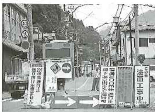
国道400号通行止め（八汐橋付近）
